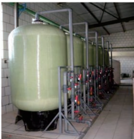
图6-12 吉林洮南供水除氟系统
