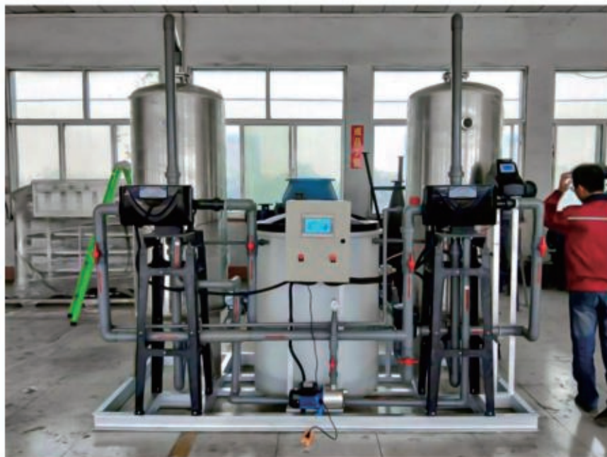
图4-13 浮动床自动控制软水处理系统
