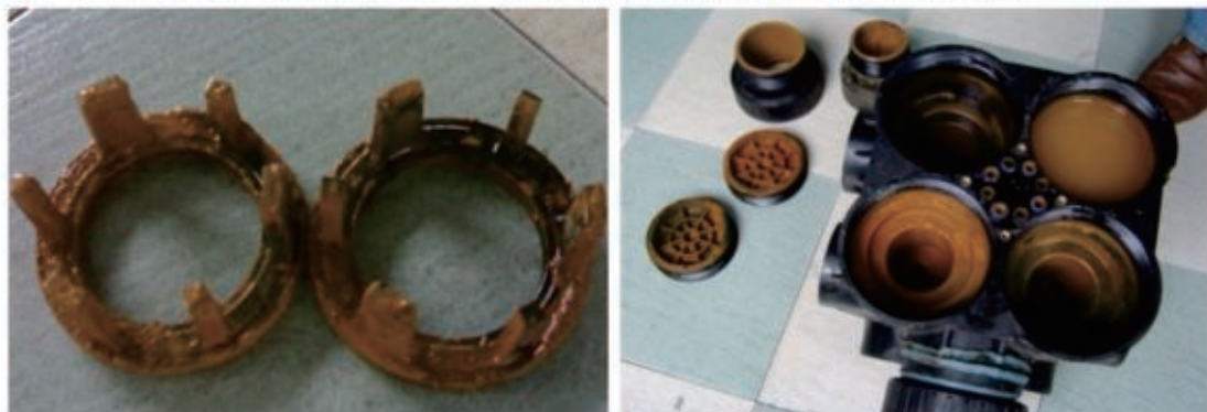
图8-12 进水浊度超标造成阀芯堵塞
