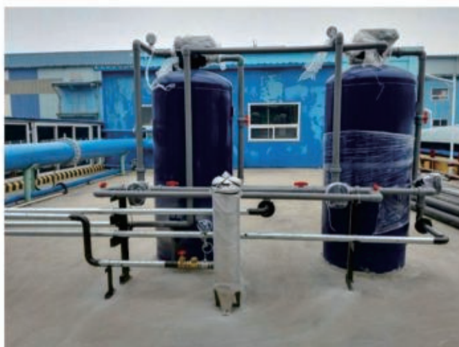
图6-6 锰砂过滤器系统
