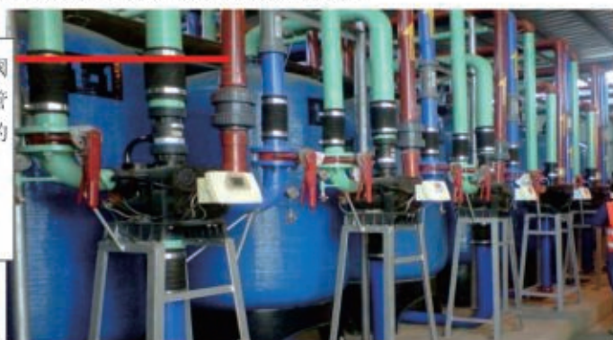
图8-10 软化处理系统排水管路有背压
