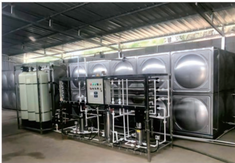
图5-8 砂滤-碳滤-软化预处理及RO系统
