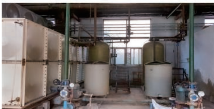
图4-20 婴儿游泳馆软水处理装置
