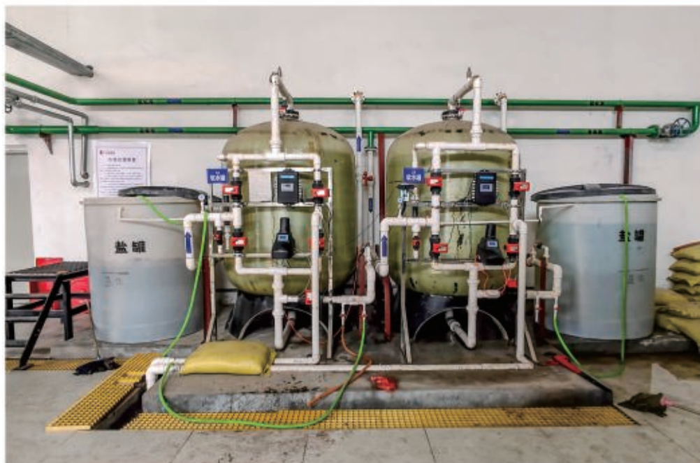
图9-7 球阀应用于锅炉补给水软化处理系统
