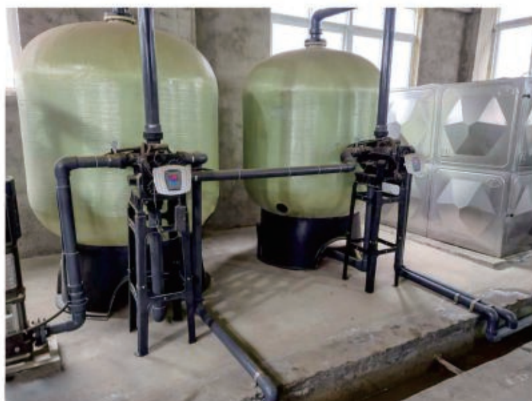
图5-11 RO系统及预处理装置
