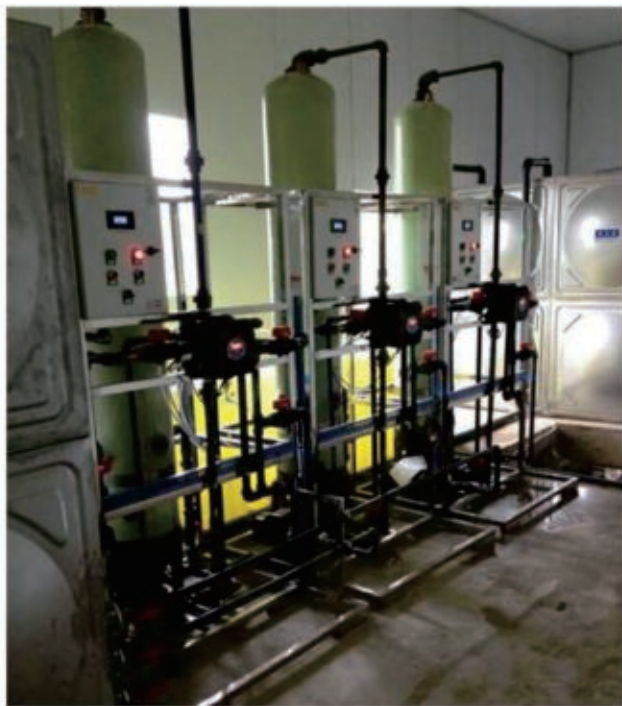
图5-12 混床处理系统
