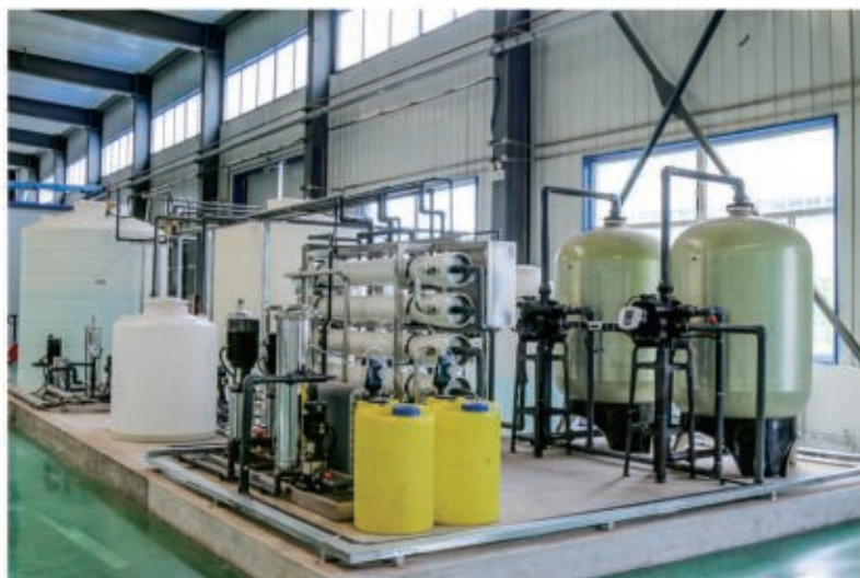
图5-10 过滤器和双级反渗透系统
