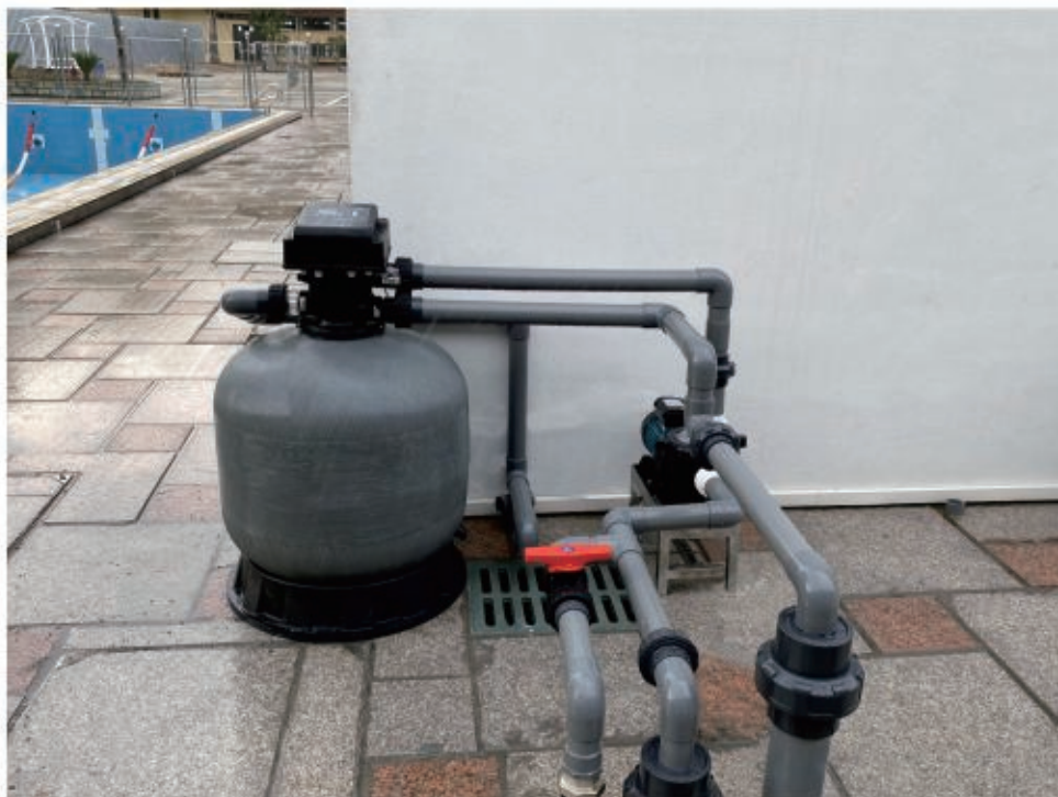
图3-21 润新阀在泳池过滤系统中的安装
