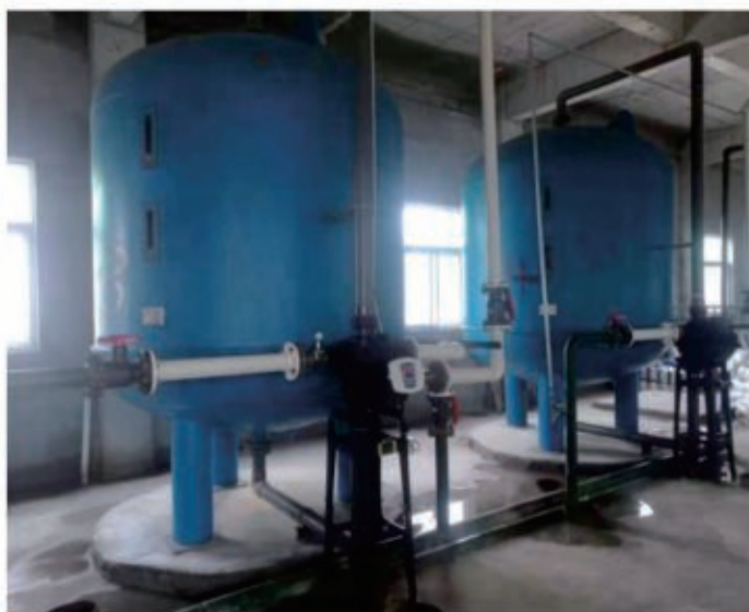
图6-9 采用自动过滤阀的海绵铁除氧过滤器装置
