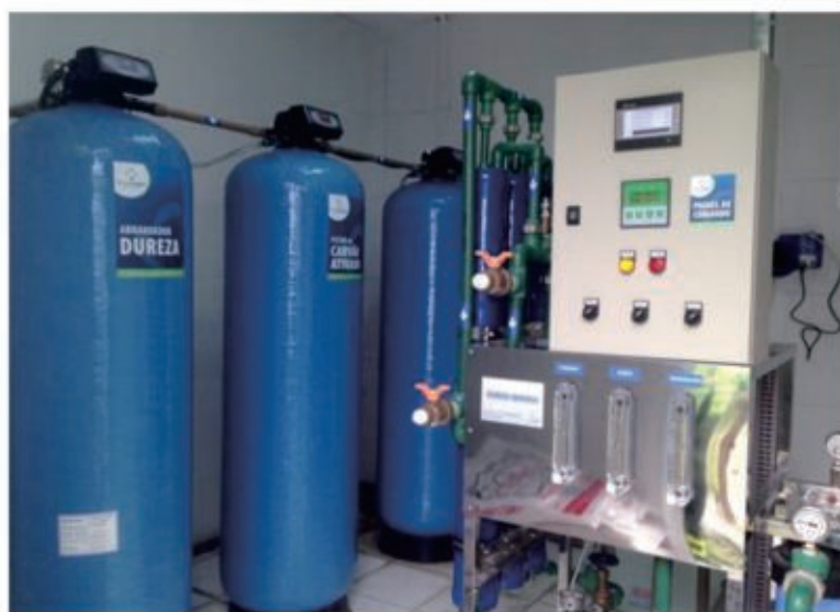
图5-7 RO 装置预处理系统
