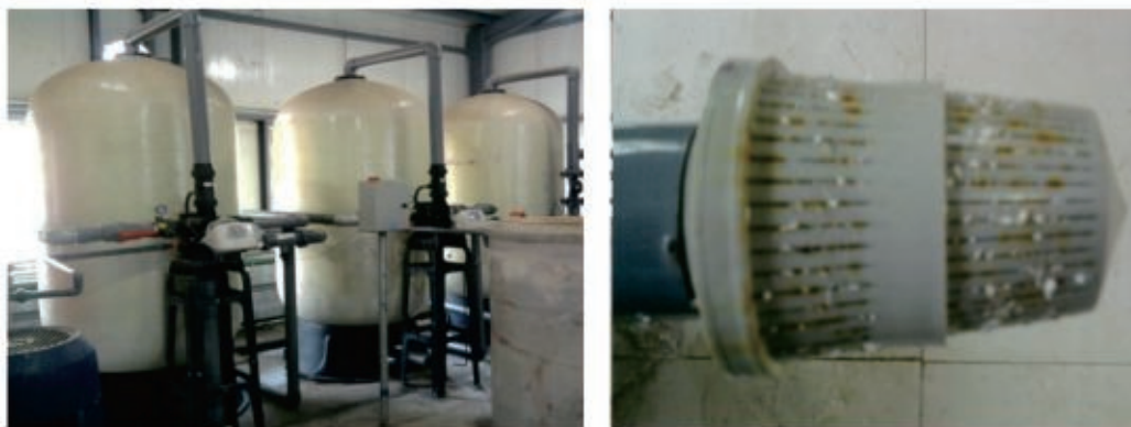
图8-7 吸盐管路堵塞
