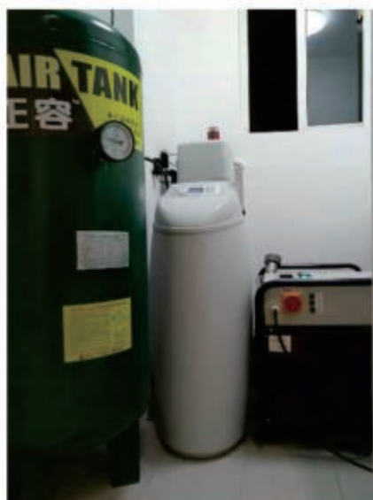
图7-5 热水锅炉配套软水器
