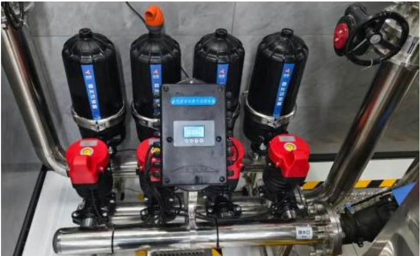
陕西榆林某小区供水系统
